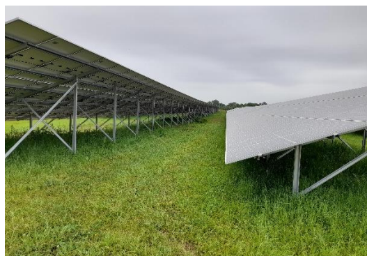
Reprise végétale sous les panneaux photovoltaïques
