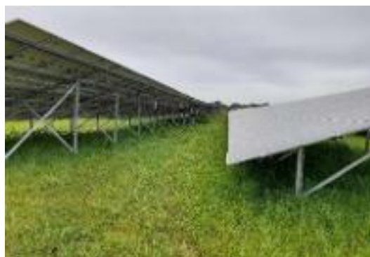
Reprise végétale sous les panneaux photovoltaïques
