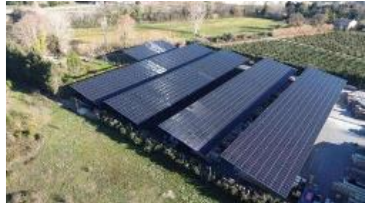
Figure 4 : Photo de la centrale en ombrières de NRD (source : MELVAN).
