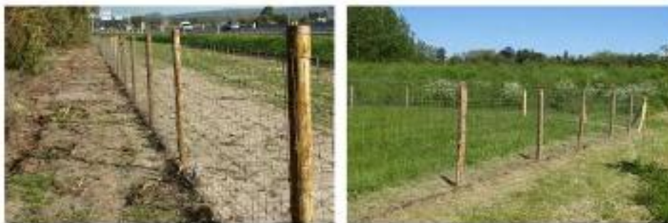
Exemple d'une clôture de parc solaire
